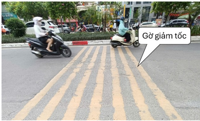
a) Gờ giảm tốc bị rạn nứt, mất độ gờ nổi
